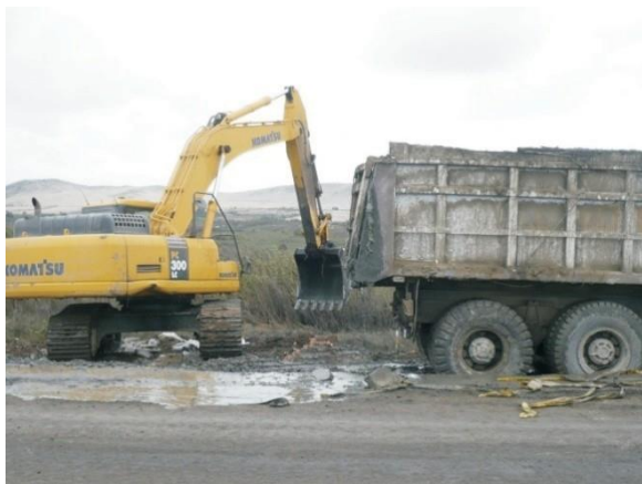
Foto 4: Ampliación de la Av. Pardo, deteriorando los espejos de agua
