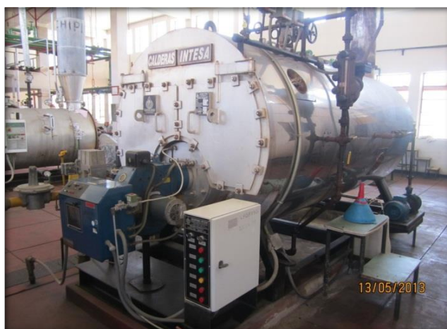
Figura 1. Caldera pirotubular INTESA de Hospital EGB.
